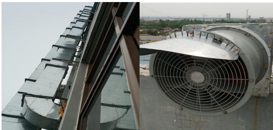
15m 高排气筒（高出楼顶）
