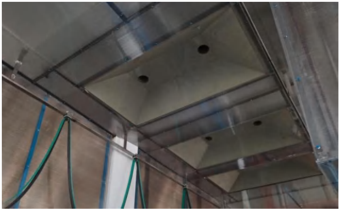
封闭式生产线内部集气系统
