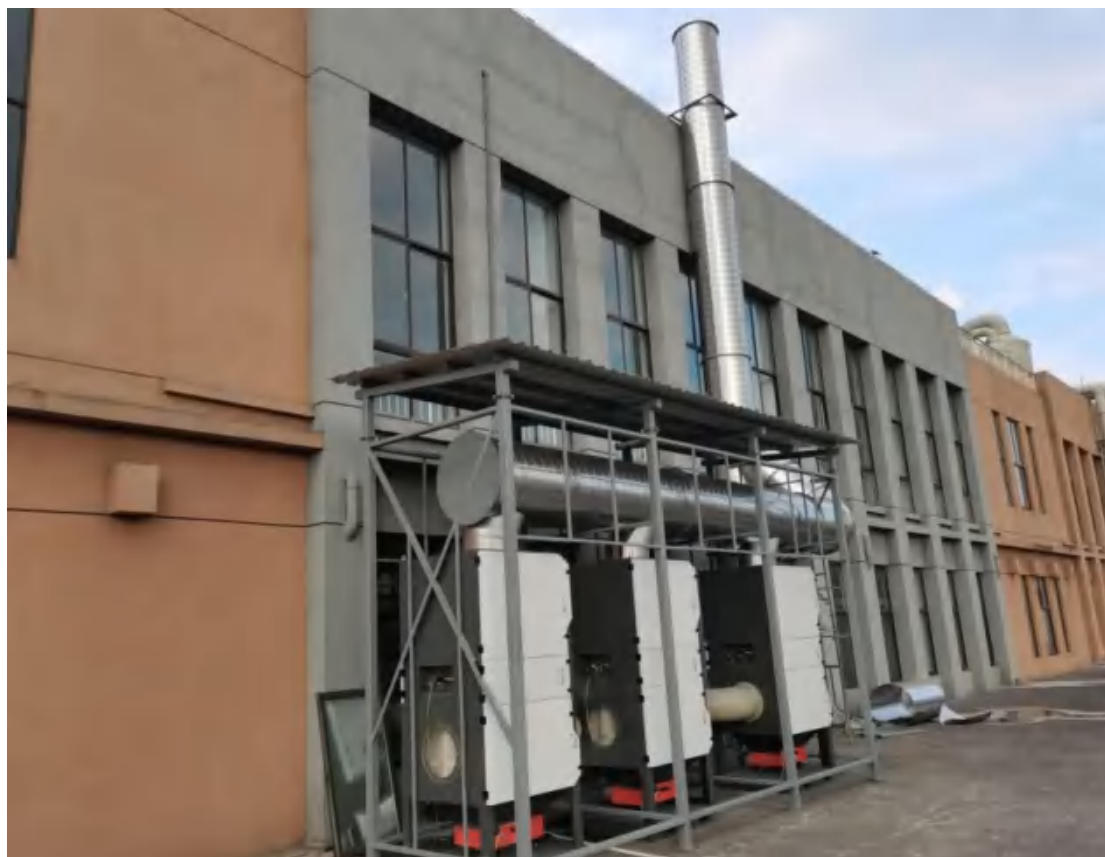
打磨工序配套滤筒除尘器及排气筒（DA003）
