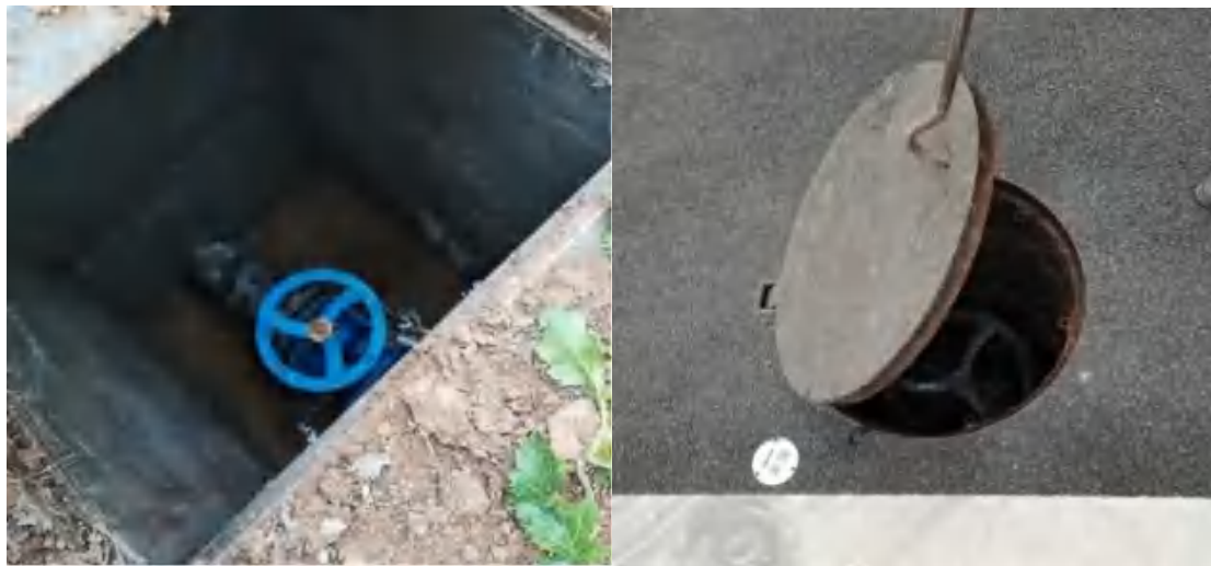
应急事故池（配套连通污水管网切换阀门）
